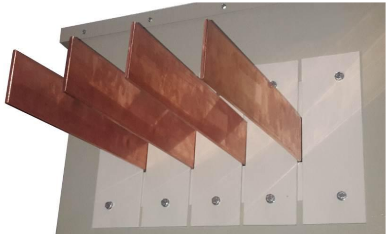
Rys. 15. Wyprowadzenie szynowe z boku transformatora.
