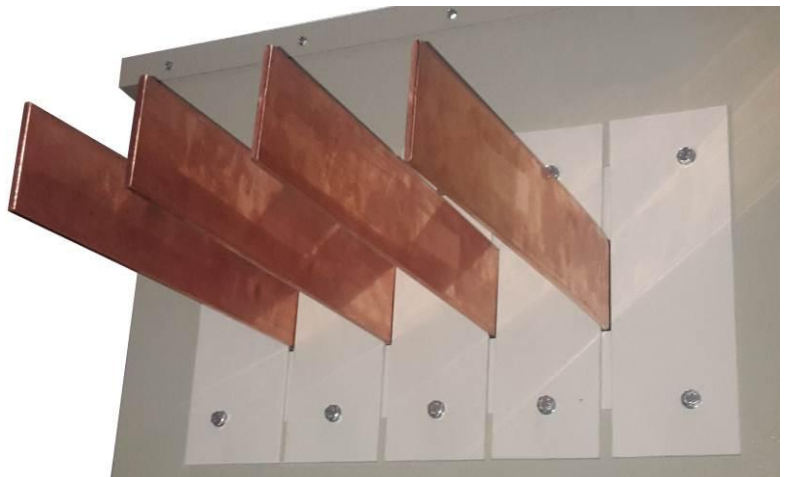
Rys. 15. Wyprowadzenie szynowe z boku transformatora.
